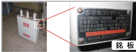
電気機器の本体についている銘板で、型式等を確認してください。
